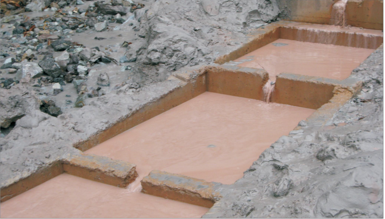
Şekil 5- Dere suyunda kirliliğe yol açan tünel içi çamurlu sular
